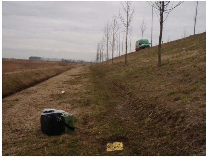
Foto: Bomen op isolerende constructie vormen risico voor de isolerende voorziening.
