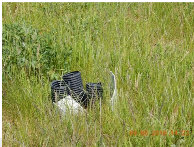
Foto: Mantel om drainageleidingen beschadigd.
