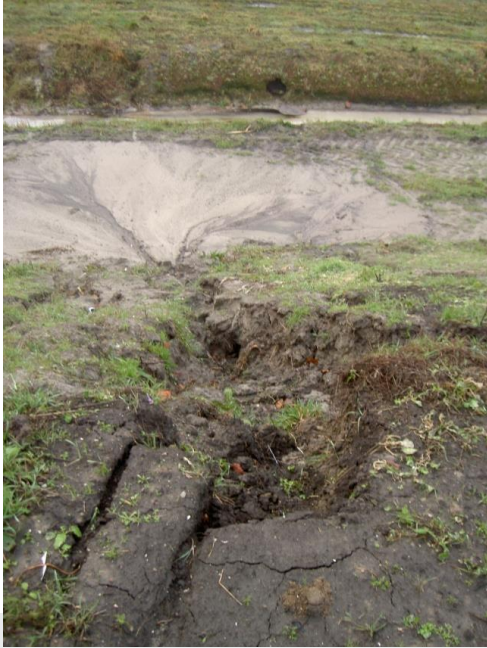
Foto: Erosie van afdeklaag.
