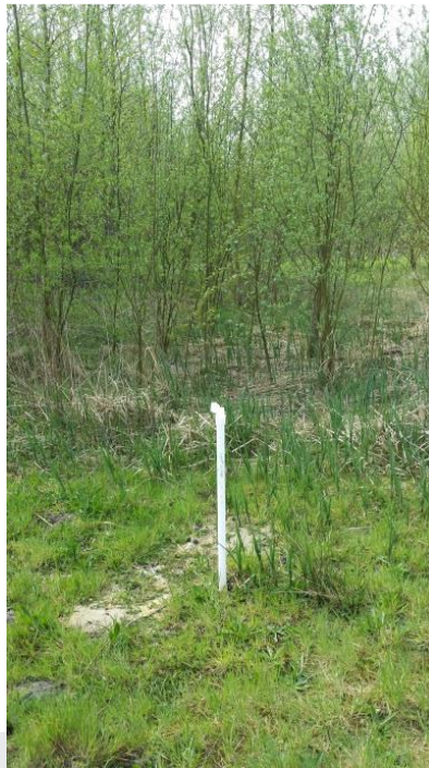
Foto: Monitoringsvoorziening kwetsbaar: peilbuis zonder mantelbuis.
