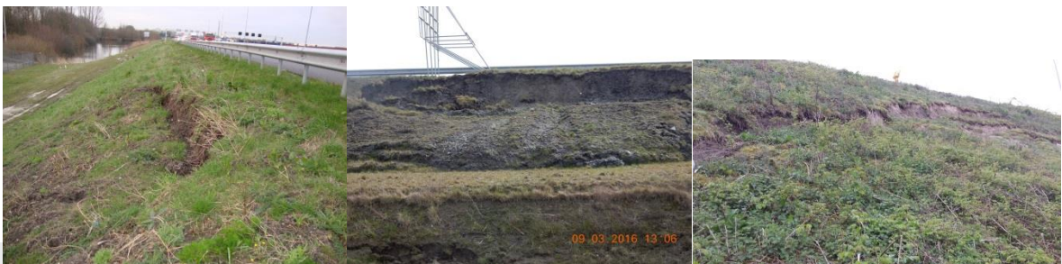
Foto: Afschuiving van talud.
